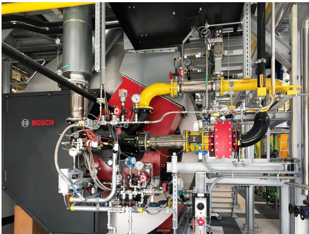
Bild_04: Bosch-Dampfkessel ausgestattet mit einer Mehrstofffeuerung zur Nutzung von Wasserstoff, Erdgas und Leichtöl.
